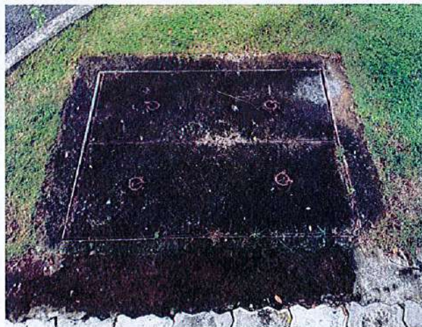
Hình 4.9. Hố ga đầu nối nước mưa của Dự án với KCN
